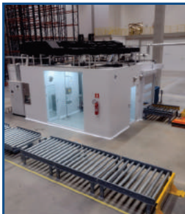
Central de Amostragem "Turn Key"
