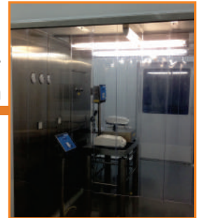
Cabine de Pesagem
