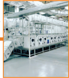
Unidade de Tratamento de AR
